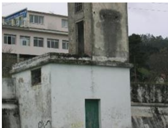
Ilustración 21. Depósito Campolongo (Vilar)
