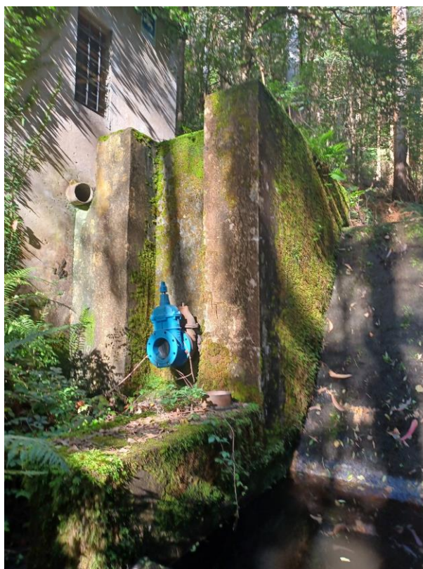
Ilustración 25. Captación Mananciais A Chancela
